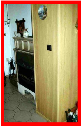
Holzverkleidung mit unzureichendem Abstand, ohne Hinterlüftung.
